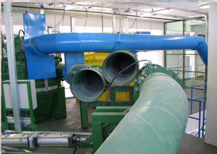
Tuberías de conducción de los RSU
